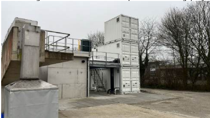
Figuur 28 Cellulose Terugwininstallatie in containers AWZI Zeewolde
