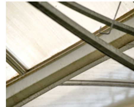
Condensgoot voor de opvang van condenswater van het kasdek.
