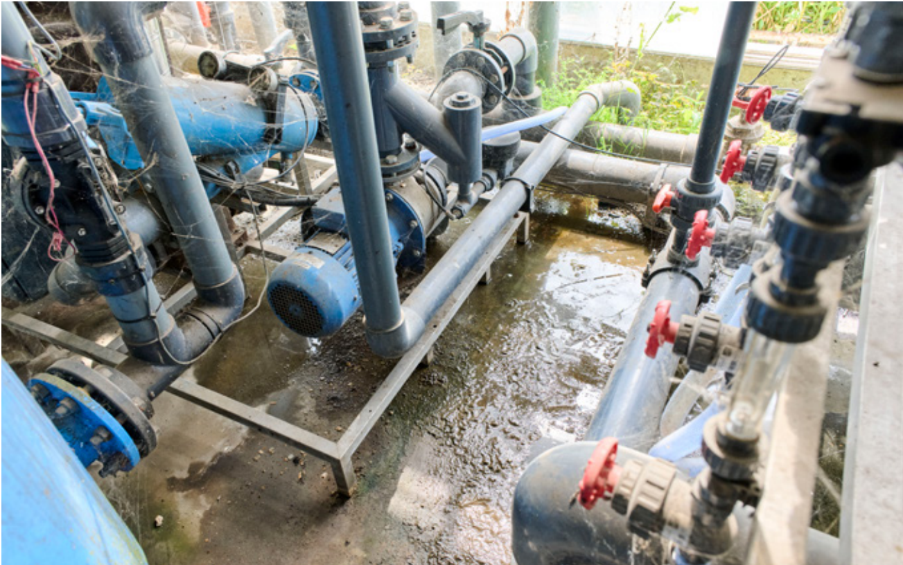
Natte plek in de ruimte bij de pompunit.
