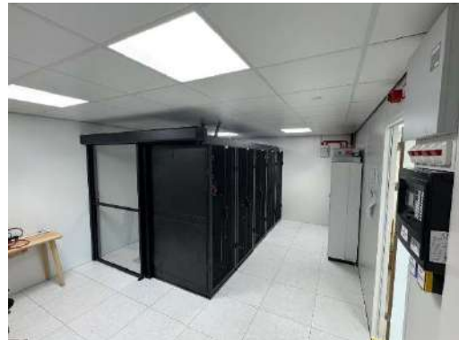
Figuur 35 Gerenoveerde serverruimte
