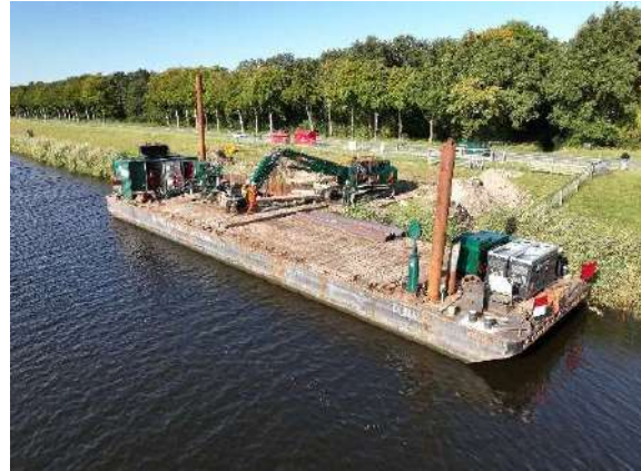
Figuur 11 Dronefoto tijdens de uitvoering van de versterking Kunstwerk Noordoostpolder eind september 2025
